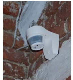
Einschalten der Beleuchtung mittels Bewegungsmelder
